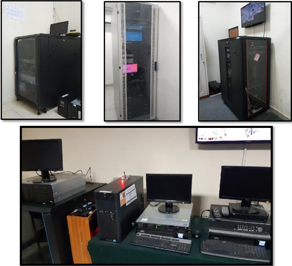
Gambar 4. 16. Server Pengadilan Tinggi dan Pengadilan Negeri se Wilayah D.I. Yogyakarta
