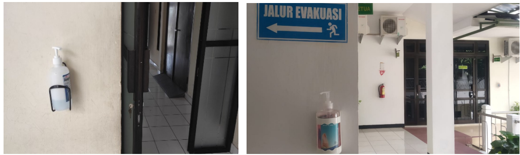
Gambar 4.6 : Penyediaan dan Pemasangan Handsanitizer
