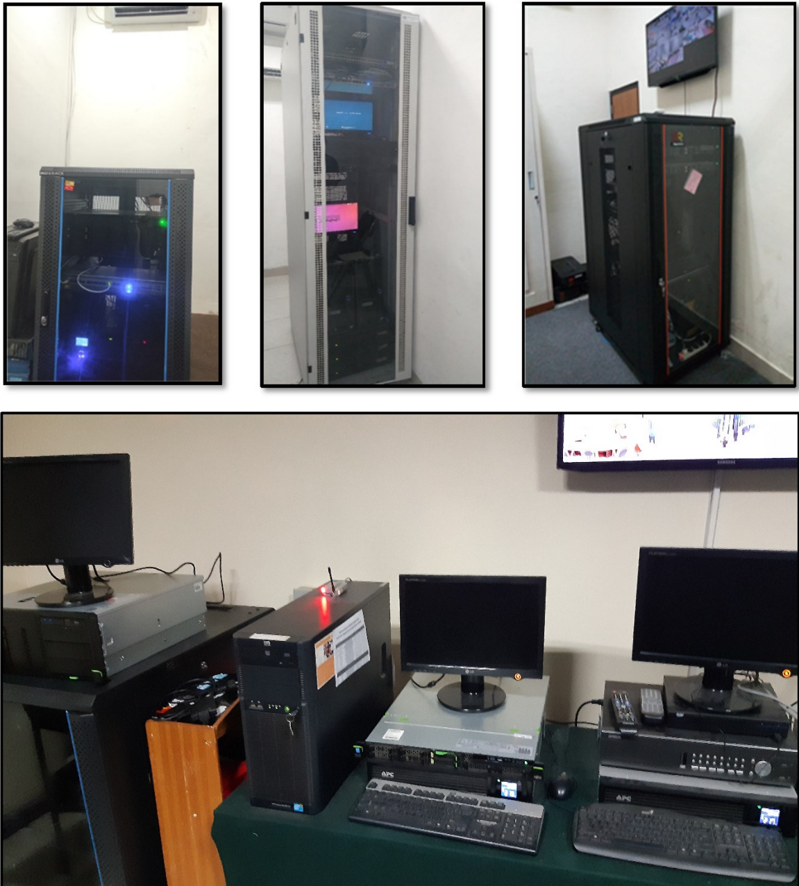
Gambar 4.14 : Server Pengadilan Tinggi dan Pengadilan Negeri se Wilayah D.I. Yogyakarta
