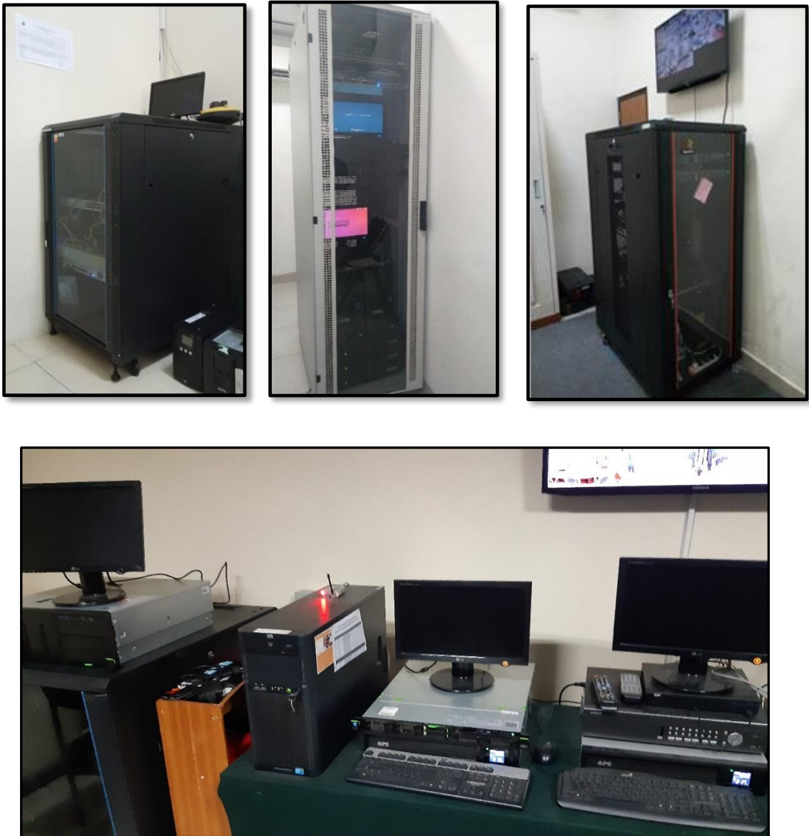
Gambar 4. 1 Server Pengadilan Tinggi dan Pengadilan Negeri se Wilayah D.I. Yogyakarta
